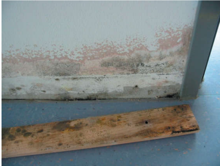
Abb. 2: Verdeckte (nicht sichtbare) Schimmelschäden: Warum sollte der Schimmelschaden unterhalb der Fußbodenoberfläche aufhören?
