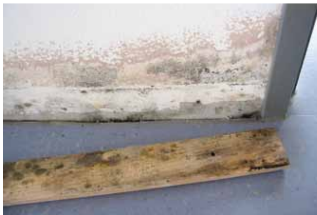
Der Schimmelschaden setzt sich auch an unsichtbaren Stellen wie der benachbarten Dämmebene des Fußbodenaufbaus fort ...
