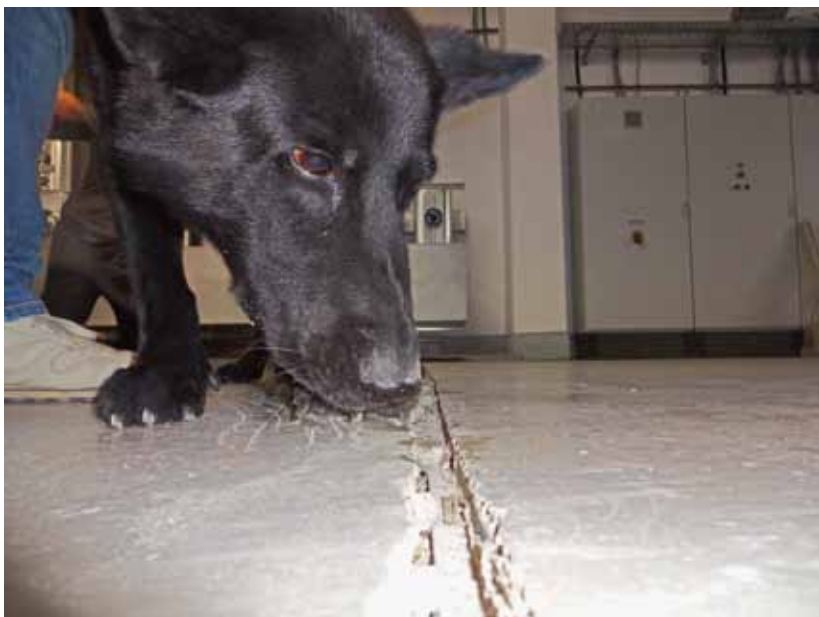
Um verdeckte Schimmelschäden aufzuspüren, ist der Einsatz eines gut geschulten Schimmelpürhundes eine kostengünstigere Alternative zur Öffnung von Bauteilen.
