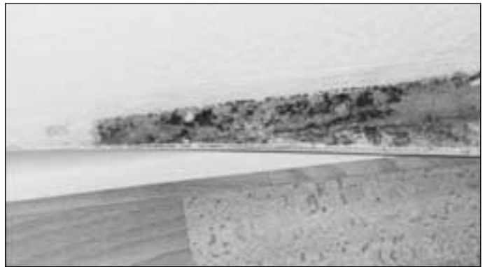
Abb. 1: Versteckter Schimmelpilzbefall hinter einer Fußbodenleiste und im Unterboden
