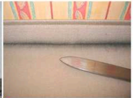
11 Ölig-schmierige und grau-schwarze Verfärbungen an der Sockelleiste belegen den Pumpeffekt des Estrichs, durch den die Partikel über die Randfuge in den Raum gelangen können
