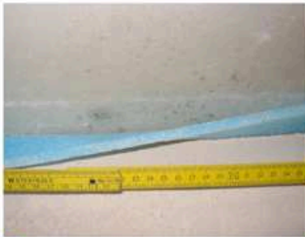
9 Entdeckt man bei einem Neubau Schimmelflecken hinter dem Estrich-Randstreifen, ist vermutlich auch die Dämmebene im schwimmend verlegten Estrich mikrobiell belastet
