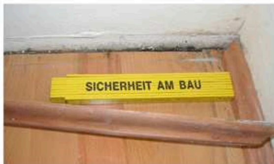
7 Verfärbungen an der Randfuge können wichtige Hinweise auf einen Schimmelpilzbefall unter dem Estrich geben
