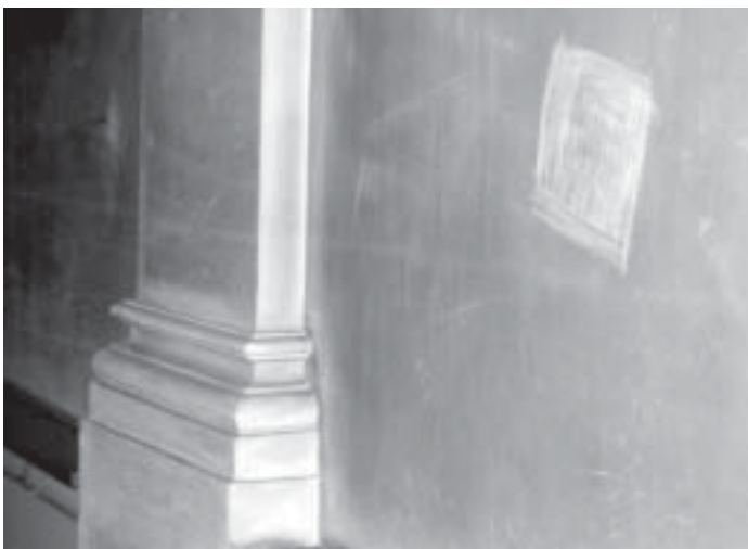
Abb. 6: Wischprobenahmestelle an einer stark mit Schwarzstaub beaufschlagten Außenwand in Kirche Nr. 2.
