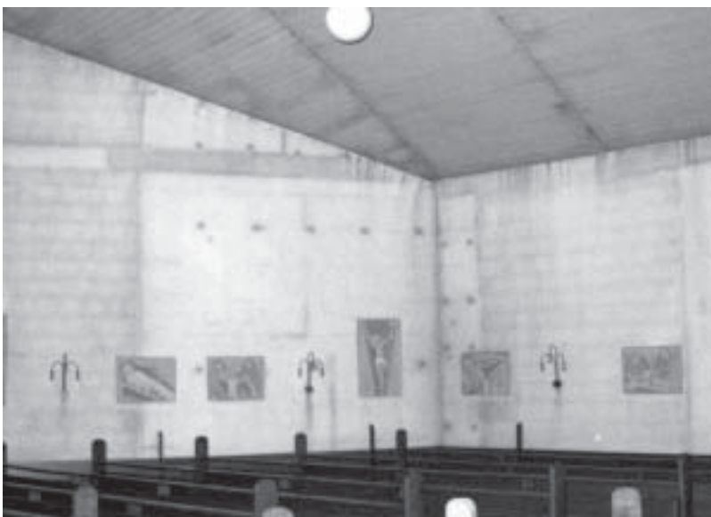
Abb. 1: Großflächig mit Schwarzstäuben beaufschlagter Innenraum der modernen Kirche Nr. 1, die im Jahr 1981 geweiht wurde.
