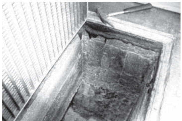
Abb. 11: Mit Schwarzstäuben beaufschlagter Bodenauslass des Heizsystems in Kirche Nr. 4, Details siehe Text.
