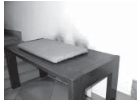
Abb. 7: Heizkreisverteiler hinter Bank in Kirche Nr. 3, erbaut 1708, letztmals renoviert 1989, Details siehe Text.
