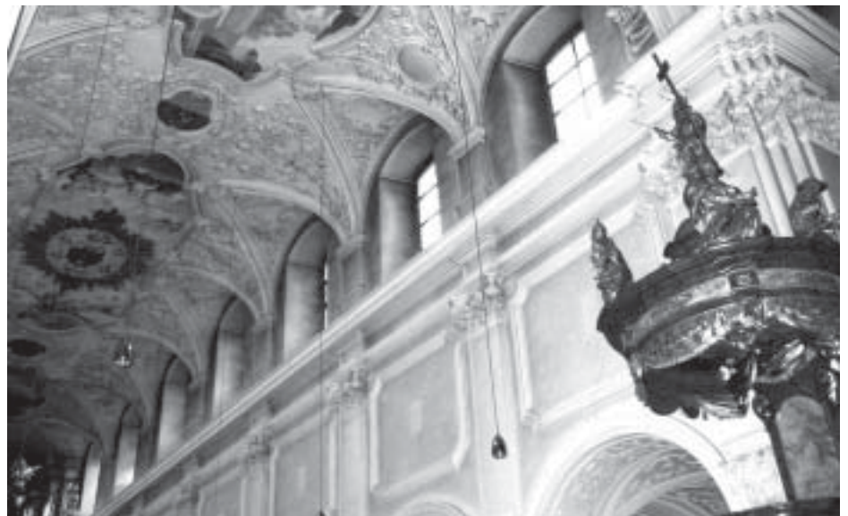
Abb. 4: Die Seitenwände im Bereich der Fenster von Kirche Nr. 2 sind intensiv mit Schwarzstaub beaufschlagt.
