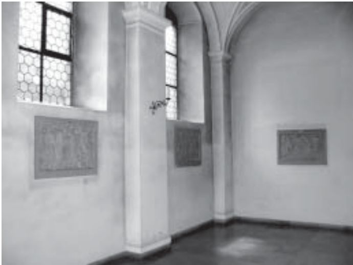
Abb. 5: Die Außenwand der Kirche Nr. 2 ist außenseitig etwa 1 m mit Erde angefüllt. Speziell in der Ecke ist im Bereich der Erddämmung die Schwarzstaubbeaufschlagung geringer, verglichen mit den höheren »ungedämmten« Wandbereichen.
