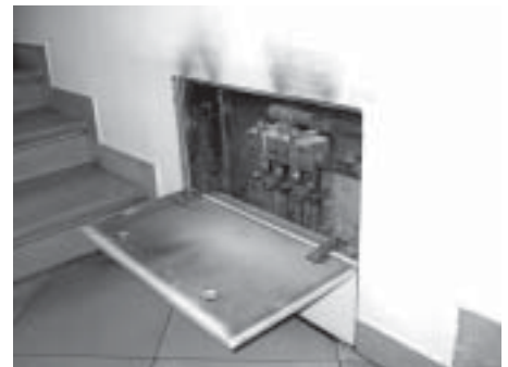
Abb. 8: Geöffneter Heizkreisverteiler in Kirche Nr. 3, Details siehe Text.
