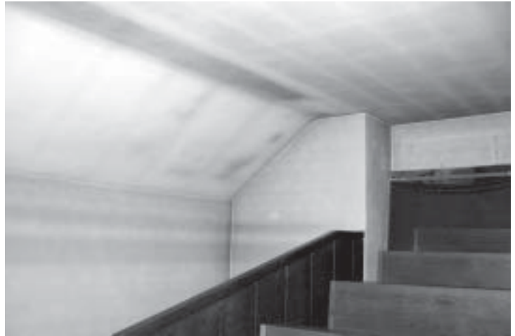
Abb. 9: Stark mit Schwarzstäuben beaufschlagte Empore in Kirche Nr. 3. Die Empore und der darunter liegende Eingangsbereich wurden im Jahr 1977 an die alte Bausubstanz angebaut.
