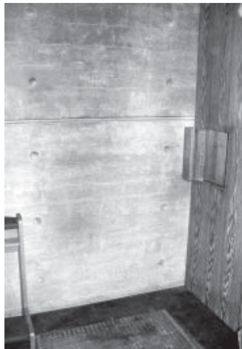
Abb. 10: Fahnenartige Verfärbungen über Bodenauslaß in der modernen Kirche Nr. 4, erbaut etwa im Jahr 1970, Details siehe Text.
